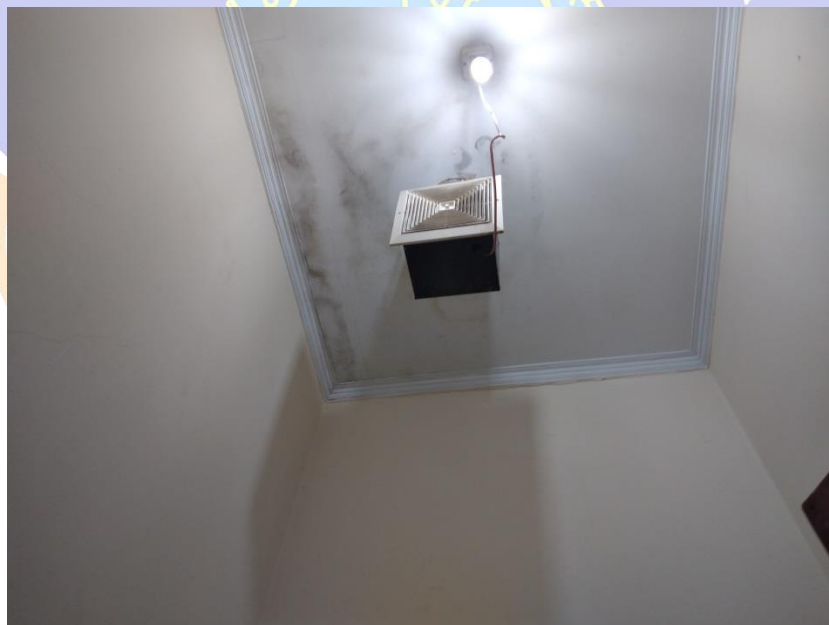
Gambar 2. Kondisi Exhaust di Ruang Penyimpanan Bahan Kimia Cair
