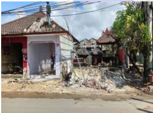
Kondisi tanah yang terkena pelebaran Sumber : arsip kantor Kelurahan Benoa
