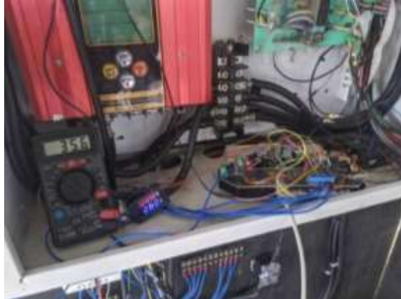
Gambar 3. 5 Penempatan dan Pengukuran Menggunakan Alat Monitoring yang Dikembangkan
