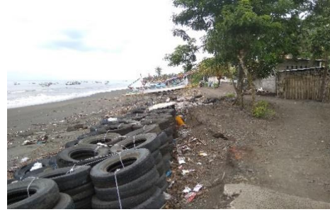
Gambar 1.2. Jalan yang rusak akibat abrasi pantai di Desa Banyubiru (Sumber : Aji, 2021)
