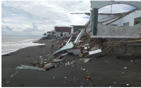
Gambar 1.1. Rumah rusak akibat abrasi pantai di Desa Banyubiru (Sumber : Aji, 2021)
