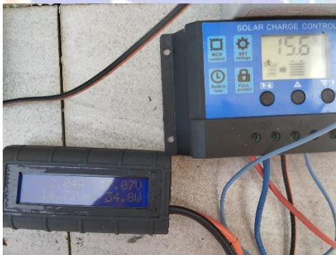
Gambar 3. Tampilan Pada Watt Meter
