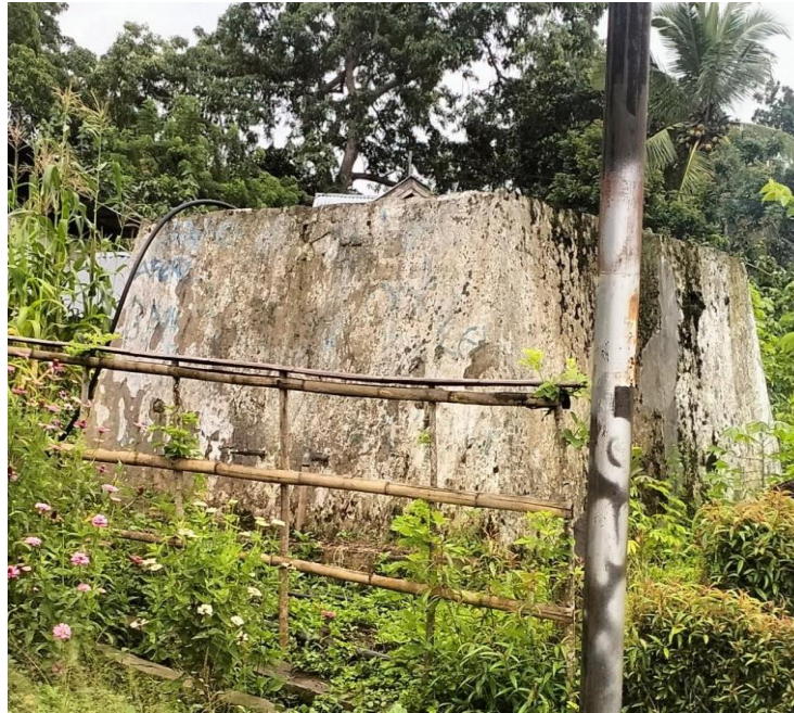
Gambar 3. Reservoir SPAM Dusun Natawulu yang mengalami kerusakan (Sumber: Dokumentasi Juang, 2024)
