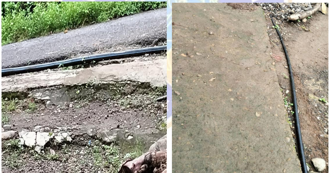
Gambar 4. Pipa Distribusi yang tidak ditanam dalam permukaan tanah (Sumber: Dokumentasi Juang, 2024)
