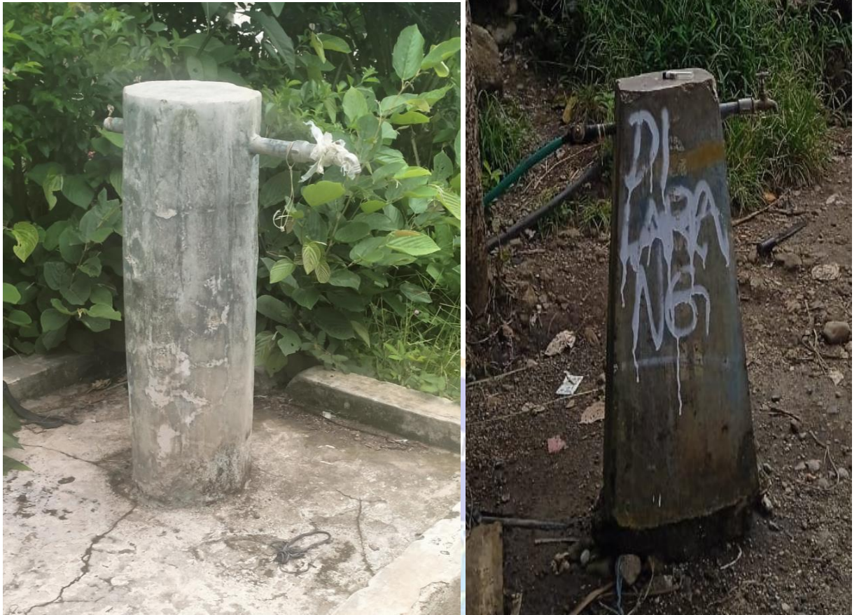
Gambar 7. Kran Umum Desa Ladogaharyang mengalami kerusakan (Sumber: Dokumentasi Juang, 2024)
