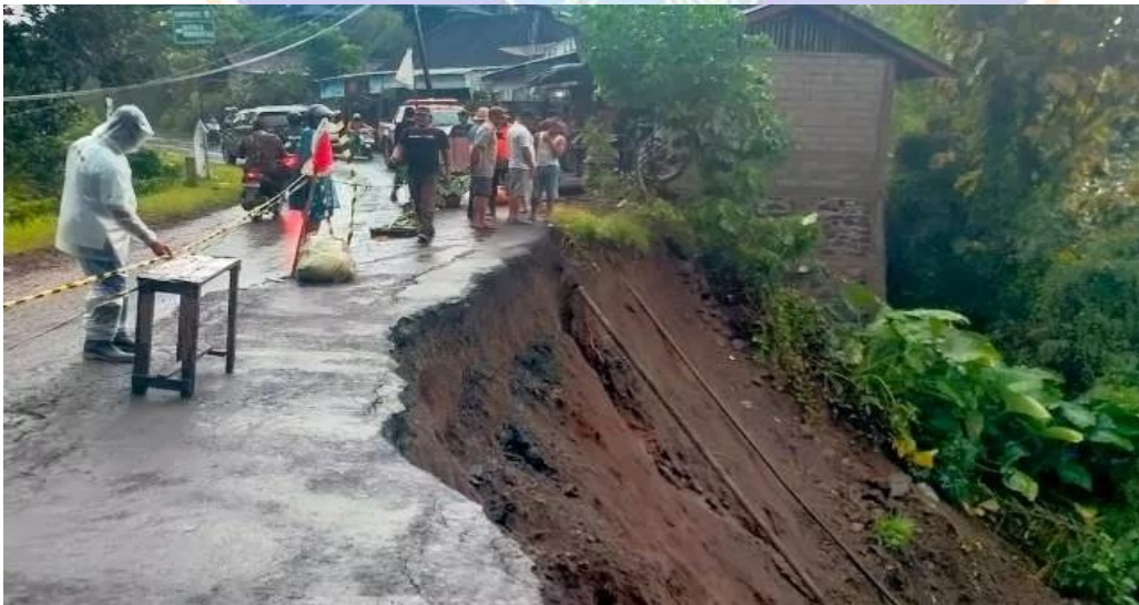
Gambar : 2. Tebing Setinggi 15 Meter Longsor di Seririt, Sebagian Jalan Longsor
