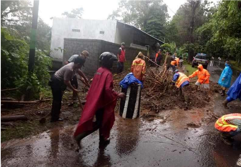
Gambar : 3. Longsor Tutup Jalan Kecamatan Seririt
