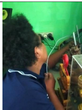
Pemasangna Kabel LAN menuju Mikrotik pada LAB TIK
