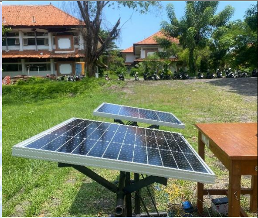
Gambar 2. Kondisi panel Pengambilan data
