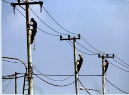
Gambar 8. Kabel Listrik Sumber: Howhaw.com
