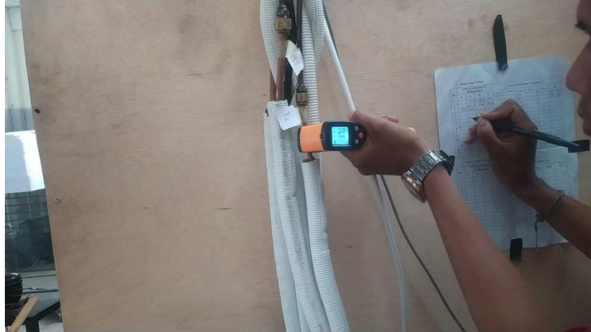
Gambar 8. Pengujian Pada Pipa Tekan Setelah Katup Ekspansi ( T_4 )
